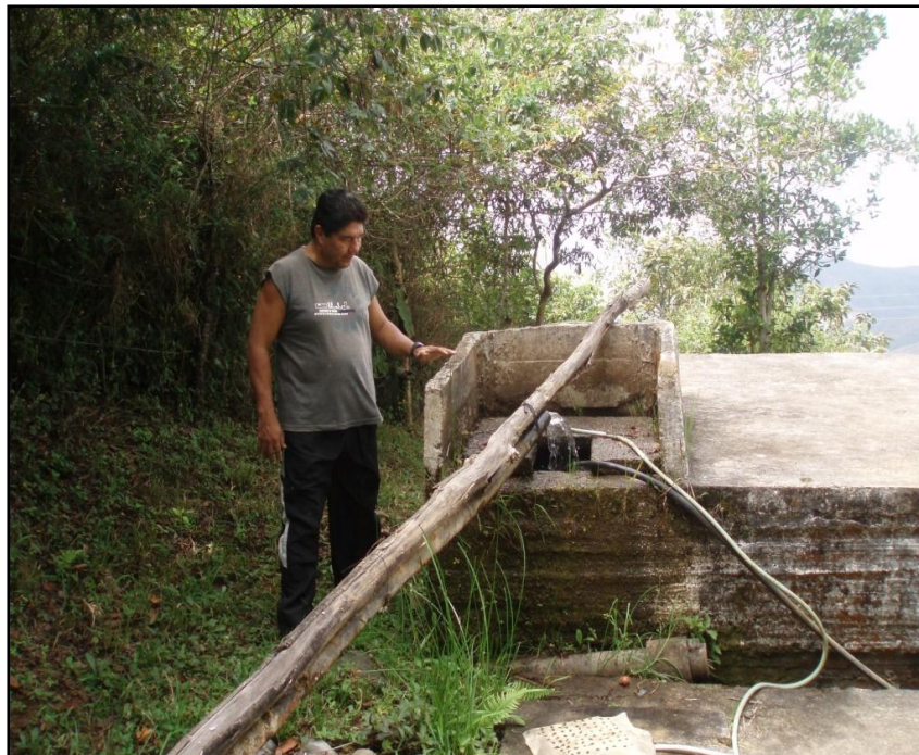
Foto No.10- Quebrada Los Alpes-La Judea: Tanque # 2 de almacenamiento- Acueducto
