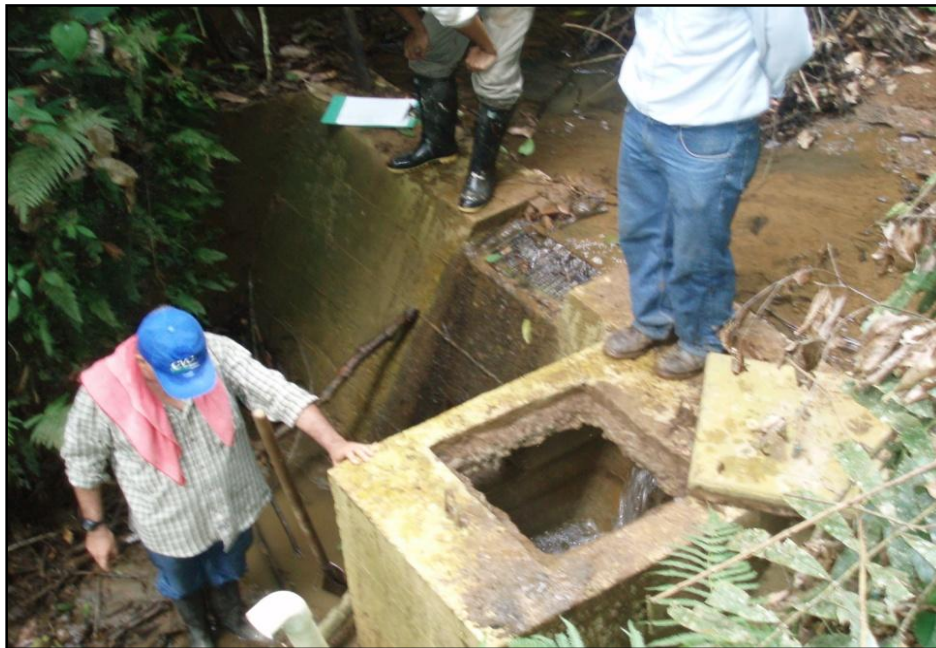
Foto No. 8- Captación Quebrada Los Alpes-La Judea: Bocatoma - Acueducto Vereda Bellavista-JACA No.5
