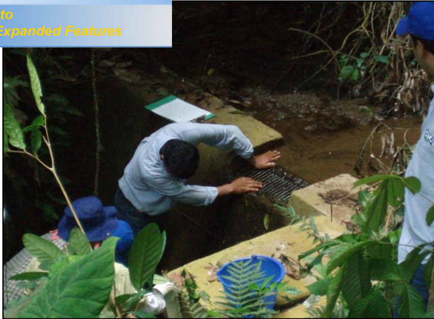
Foto No.7- Bocatoma sobre la Quebrada Los Alpes-La Judea, para el Acueducto JACA No. 5
