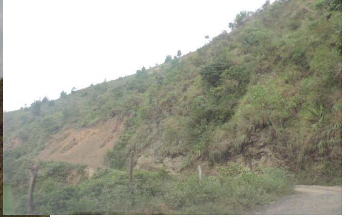
Fotografía 4-39 Cortes en la vía que conduce al Ceral
