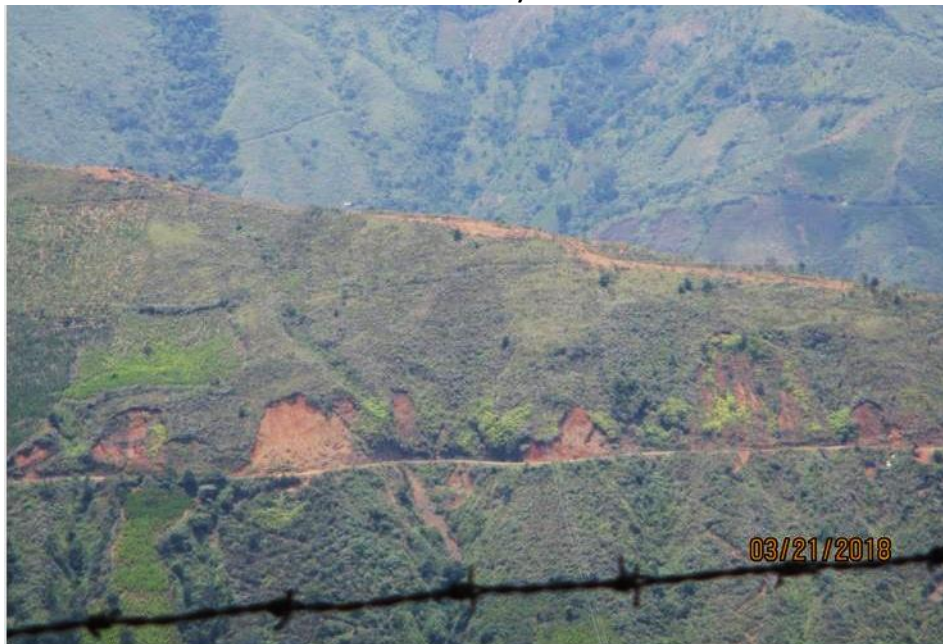
Fotografía 4-34. Movimientos en masa generados por la construcción de la vía Porvenir – Ceral (MI Rio El Silencio)
