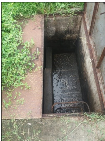
Fotos 7 y 8: Filtro Anaerobio
