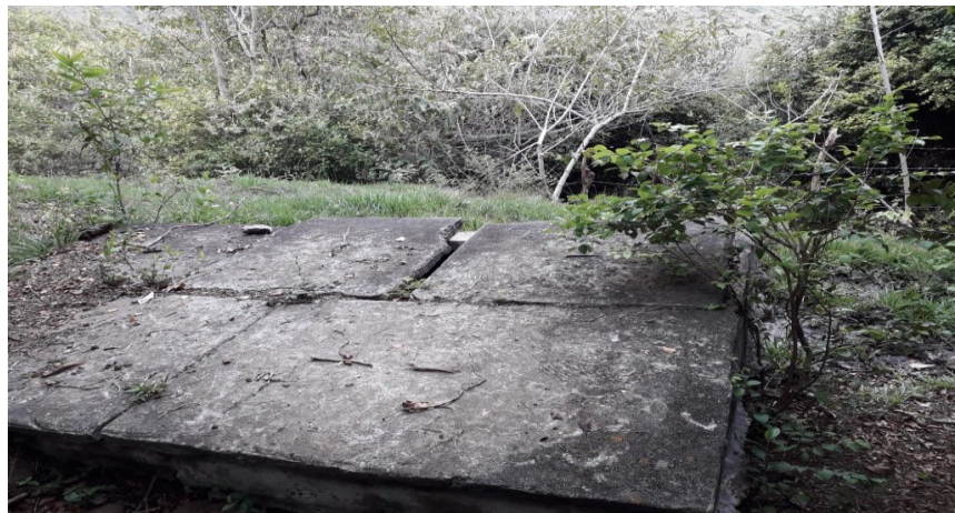
Imagen 3, tanque de almacenamiento y distribución.
