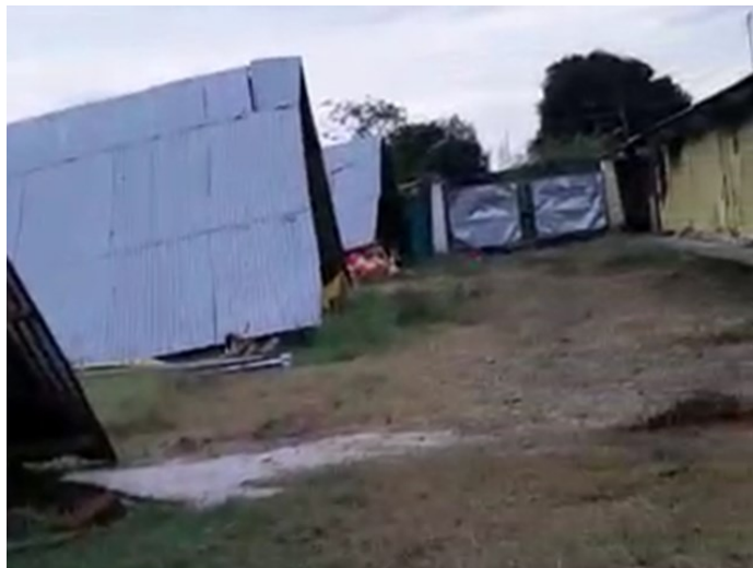
Foto 1. Se observan los galpones con el techo en tierra a raíz del colapso estructural.
