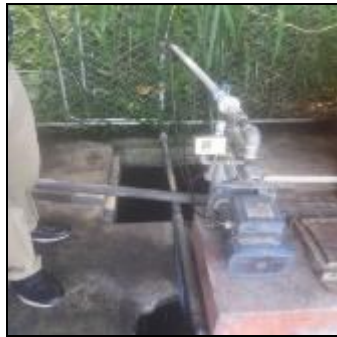
Foto 1. Sistema de bombeo
