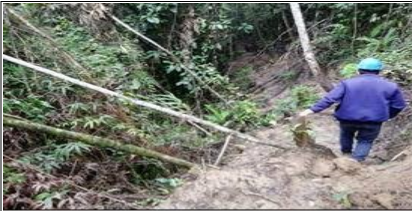
Fotos 11 y 12. Trocha construida para la tubería de obducción, donde además se verifica la afectación de árboles nativos, algunos característicos de la Reserva Forestal Protectora Nacional – RFPN de Guadalajara.
