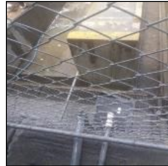
Foto 2. Caja de registro
