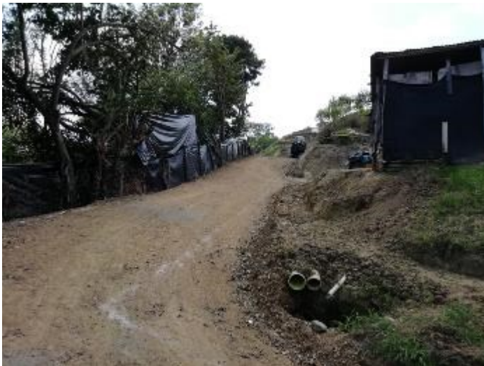
Foto 21: Colectores de aguas de escorrentía de la vía.
