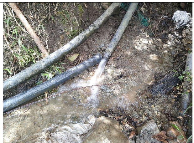
Foto 2. Conducción de agua por manguera de 2" de diámetro.
