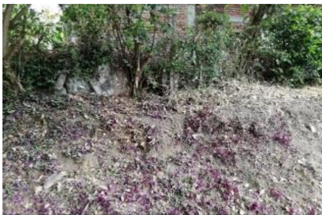
Fotos 13, 14 y 15: en las fotos se señala la explanación y la cercanía a la vivienda del predio lindero, indicando el grado de riesgo de probable afectación de la estructura.
