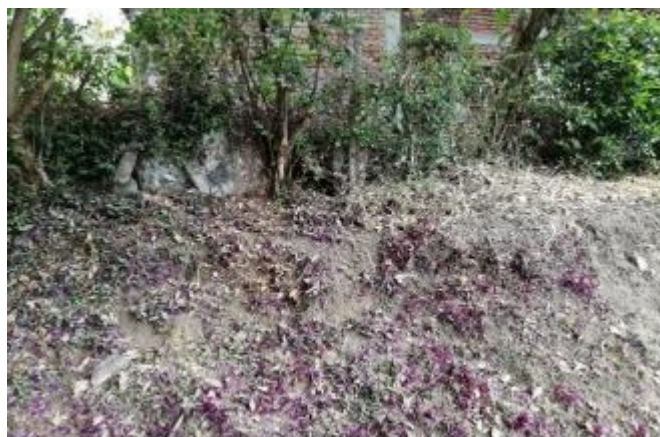
Fotos 13, 14 y 15: en las fotos se señala la explanación y la cercanía a la vivienda del predio lindero, indicando el grado de riesgo de probable afectación de la estructura.
