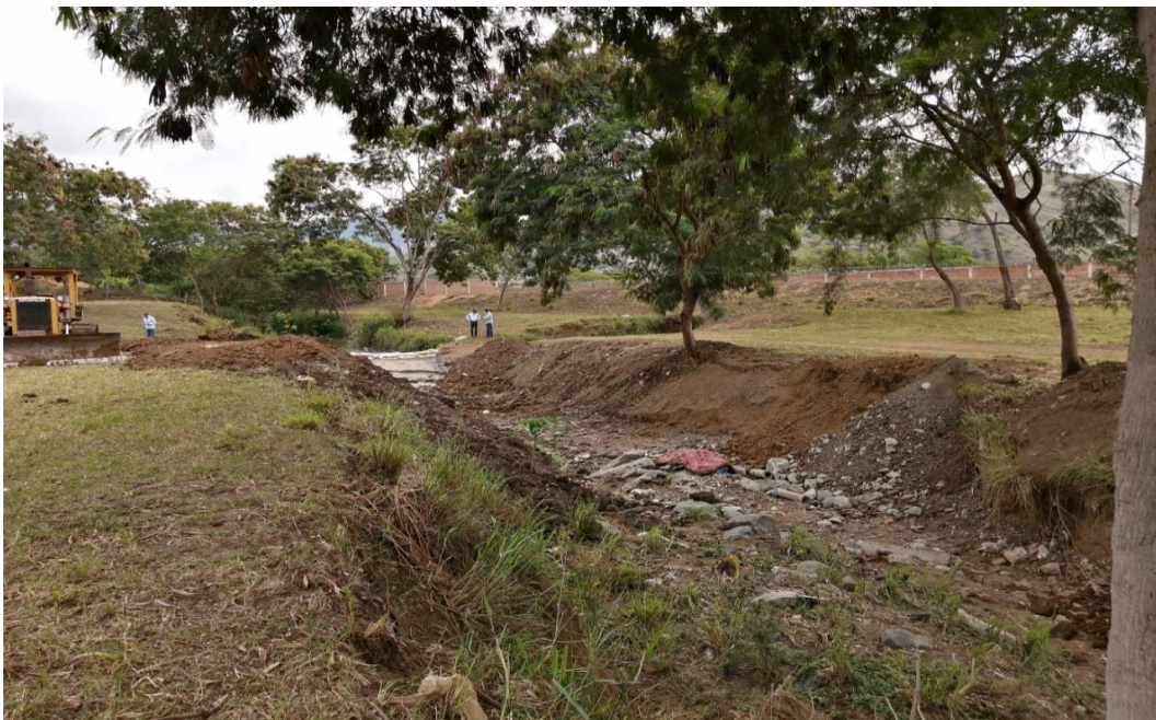
Foto 1. Vista general del material depositado en el cauce, foto tomada en dirección aguas arriba.
