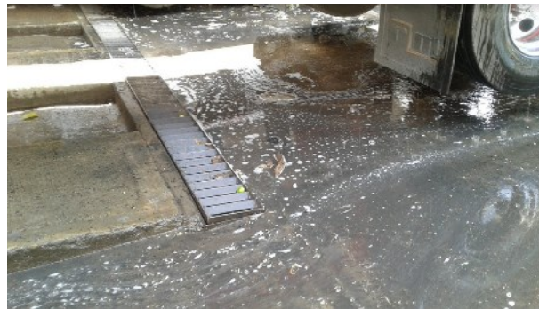
Ilustración 7 Canaleta de retención de sólidos – Lavadero Las Américas
