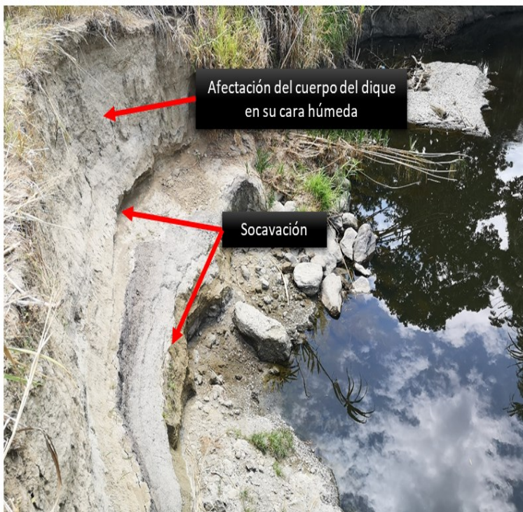
IMAGEN 2 - Estado del dique margen izquierda río Amaime predio El Ocaso aguas debajo de la vía El Cerrito - Rozo
