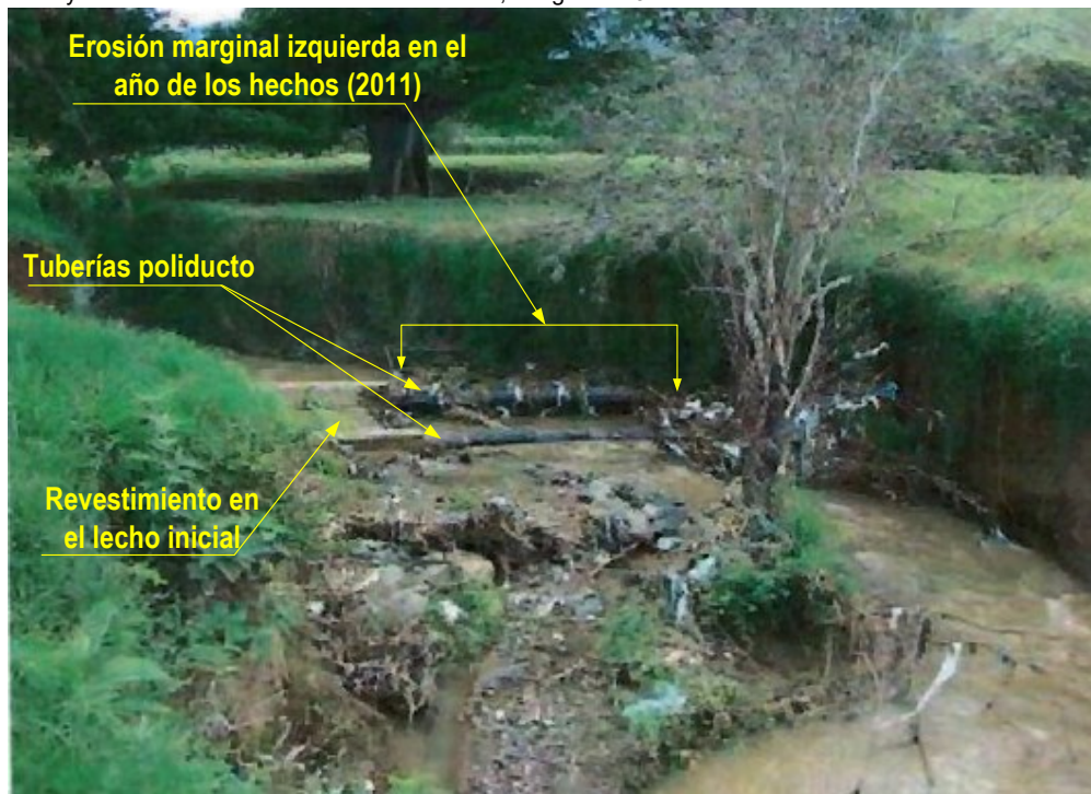
Imagen No. 5. Obsérvese las tuberías del poliducto expuestas por la socavación y erosión, principalmente hacia la margen izquierda y el revestimiento en concreto que la corriente no puede mover, por lo cual se genera la inestabilidad. Tomado: Expediente, informe Agosto de 2011, INGENIERÍA Y GEOTÉCNICA LTDA.
