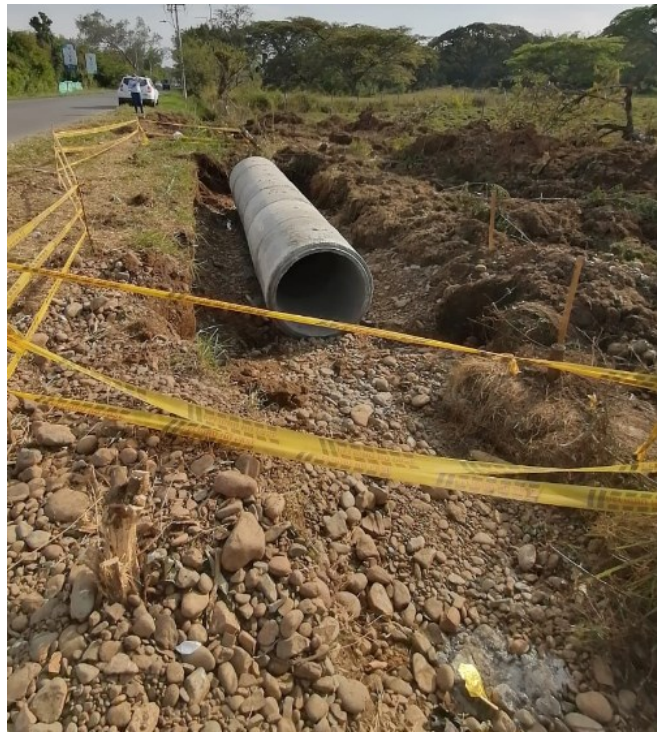
Imágenes 2, 3, 4 y 5: instalación de tubería de sobre el cauce natural de la Ramificación 4-1-4 del río
