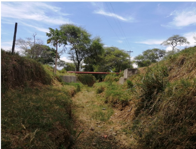
Imagen No. 3. Vista aguas hacia aguas abajo sitio de interés, cruce poliducto Cartago – Yumbo con el cauce del río Vijes.
