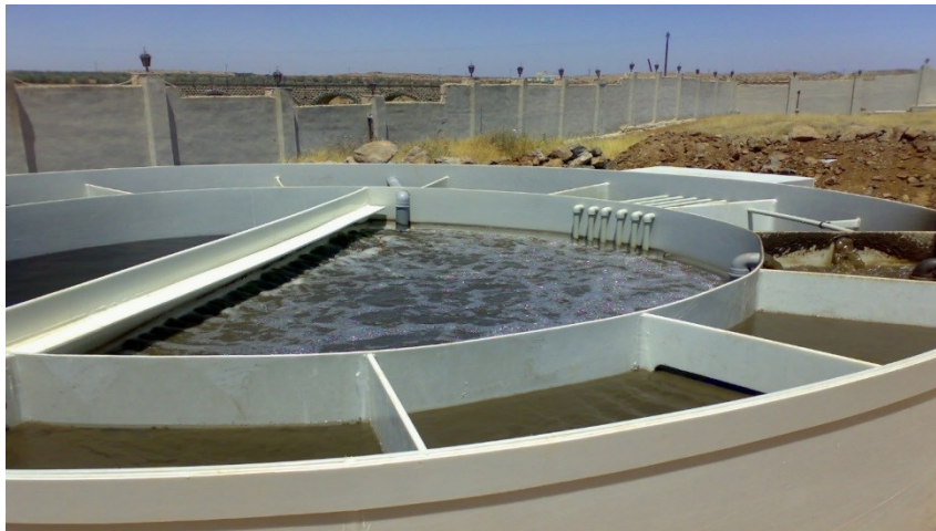
Imagen 2. PTAR ESTAR 125™ Reactor biológico.
