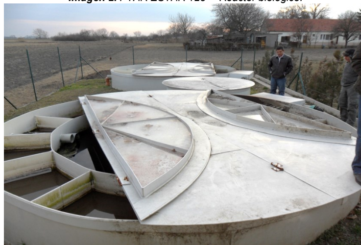
Imagen 3. PTAR ESTAR 125™, Reactor y tanques de salida.
