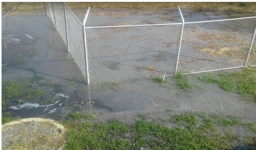
Ilustración 5 Inundación de aguas residuales y traza de grasas
