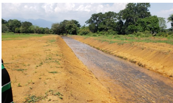
Foto 1. Intervención sobre el Zanjón Villegas. Fotografía tomada aproximadamente en la abscisa 2+454, en dirección aguas arriba del Canal. Visita Técnica 10/12/2019
