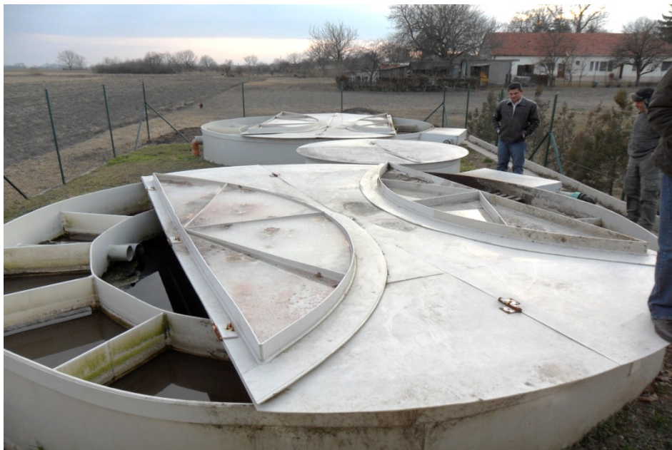
Imagen 4. PTAR ESTAR 125™, Reactor y tanques de salida.
