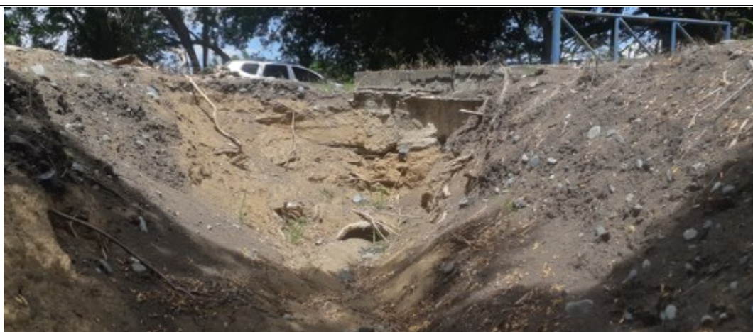
Fotos 2 - 3. Se observa la boca o entrada de la tubería del canal de drenaje y la salida del mismo, parcialmente cubiertas por desprendimiento de tierra desde las paredes o taludes.
