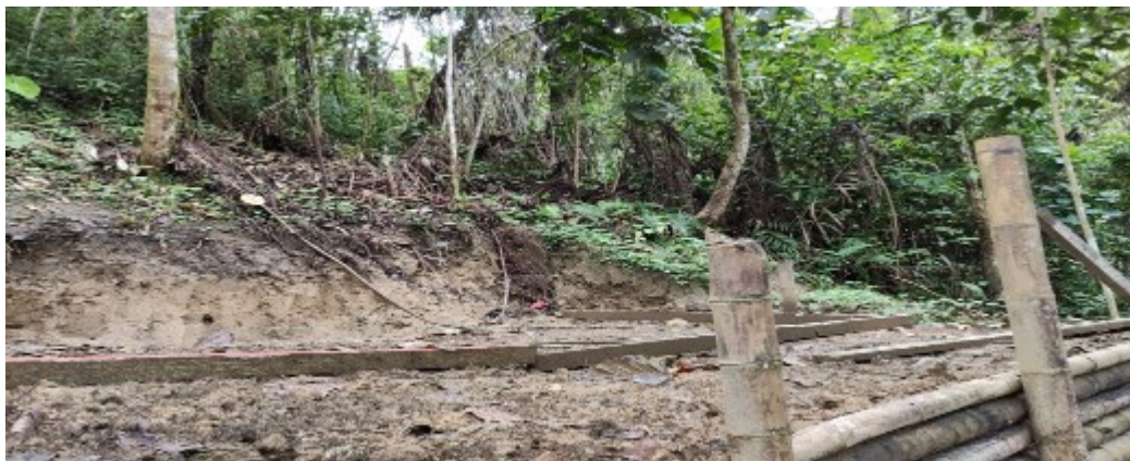
Imagen No. 7. Adecuación espacio, en deterioro
