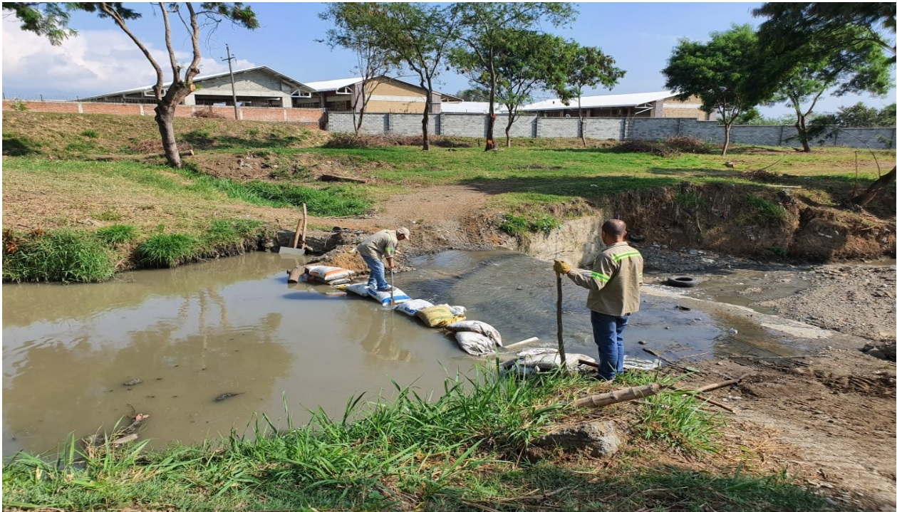
Levantando el trincho con trabajadores de la ESPY en el rio Yumbo, restableciendo el caudal ecológico del rio
