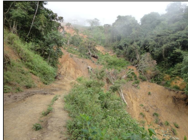
Foto 2 Deslizamiento de la vereda Mateguadua. Fuente: VEI&A Enero 18 de 2012
