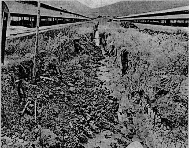
Derrumbes en talud del canal dentro del predio.
