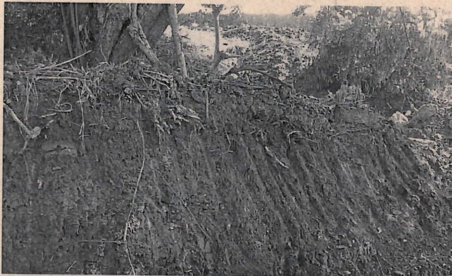
Ilustración 2 Corte de raíces de los árboles ubicados sobre el talud
