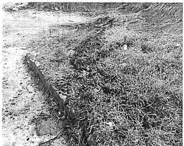
Ilustración 6. LIXIVIADOS DERRAMANDO HACIA LA QUEBRADA ORTEZ. DANIEL H. CVC 2022.
