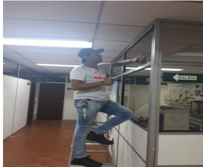
Imagen 12. Evidencias de instalación de vidrios de seguridad en el Laboratorio Ambiental
