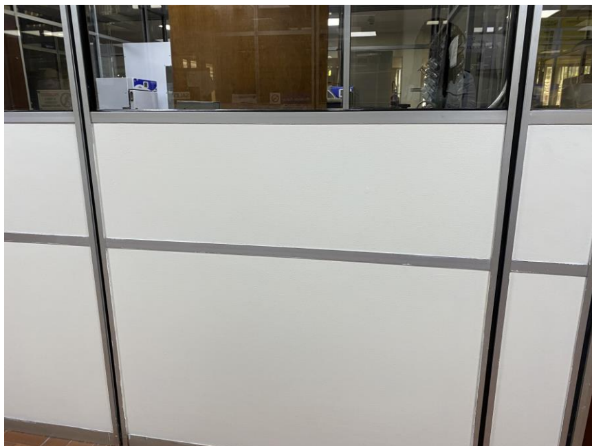
Imagen 11. Paredes de asbesto en Laboratorio Ambiental
