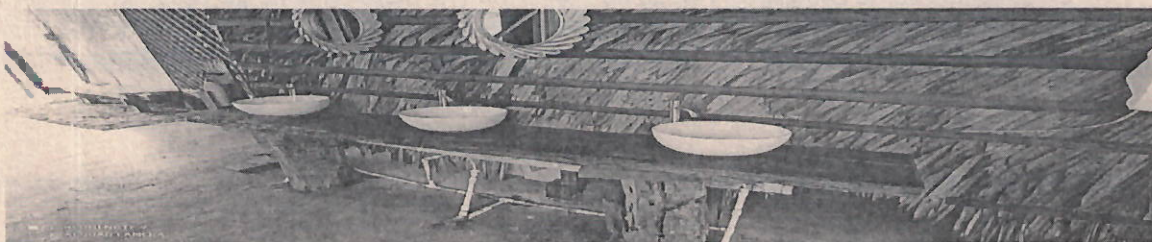
Foto 3. Lavamanos zona de baños comunes, Hotel Casa Azul.
