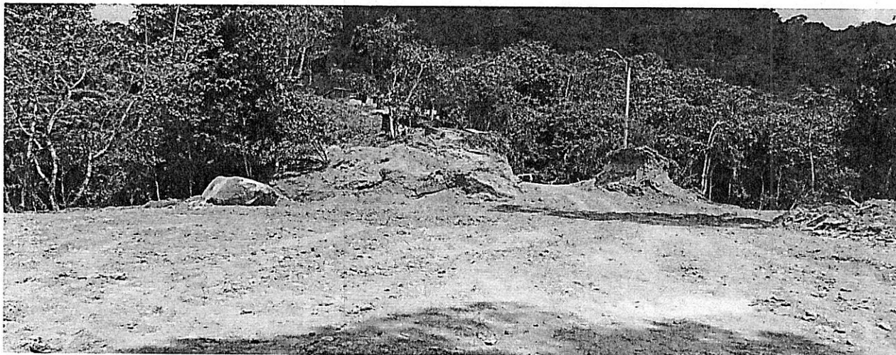
Foto 2. Dimensionamiento de la explanación realizada, foto tomada desde el interior del predio.
