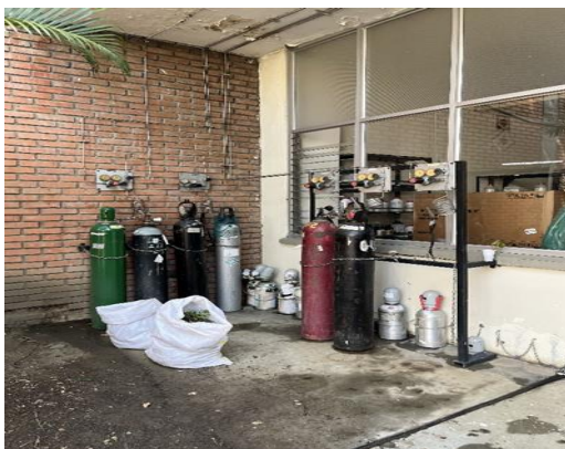
Foto 24 – Zona almacenamiento gases no inflamables
