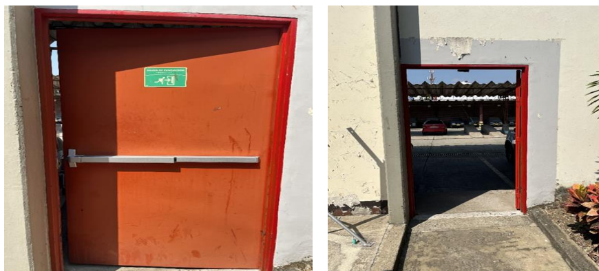
Fotos 25 y 26 – Salida de emergencia
