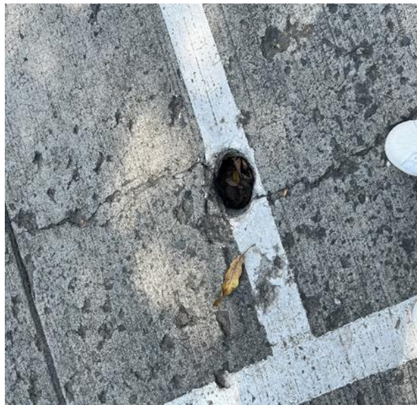
Foto 6 – Hueco pavimento salida del laboratorio
