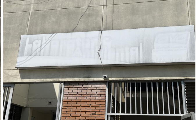
Foto 5 – Aviso deteriorado Laboratorio Ambiental
