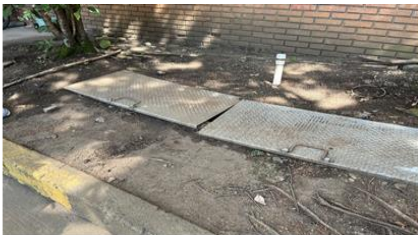
Foto 21 – Caja de inspección o monitoreo, afluyente del laboratorio
