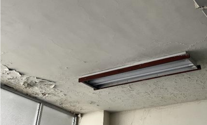
Foto 4 – Humedades cielo raso primer piso Laboratorio Ambiental
