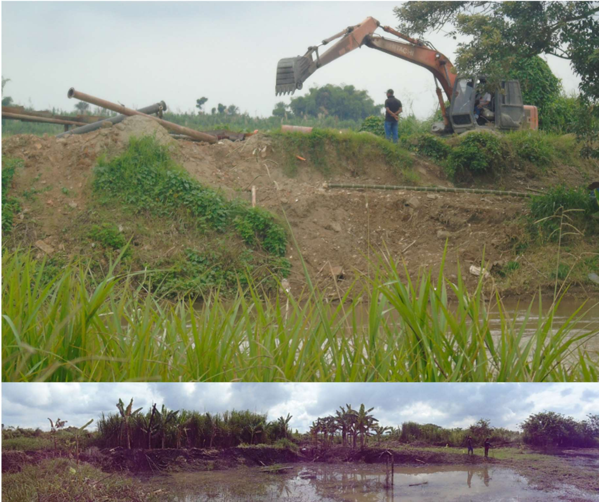
Figura 54 Alteración de la franja protectora del humedal Santa Barbara, obras pertenecientes a la empresa de dragado. Tomado de Convenio 207 de 2021.
