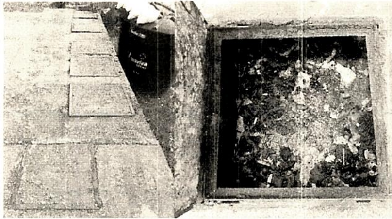
Foto N° 2. Planta general del sistema de tratamiento y entrada al tanque séptico.
