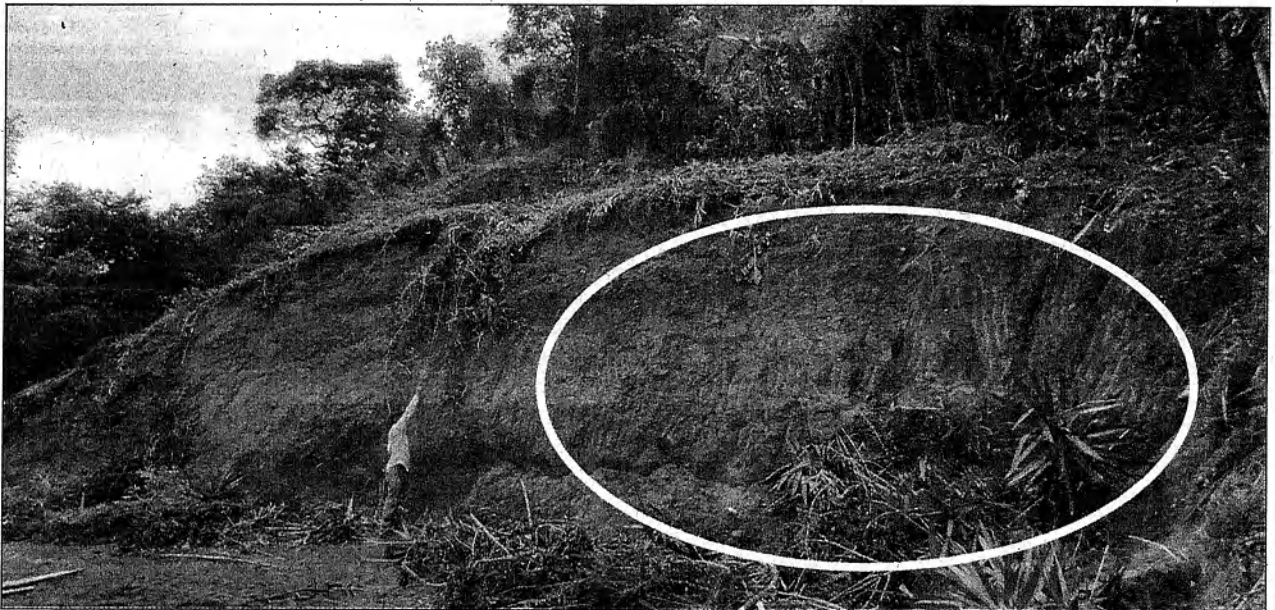
Foto 2. Vista de los taludes del terreno producto del movimiento de tierra con maquinaria pesada.
