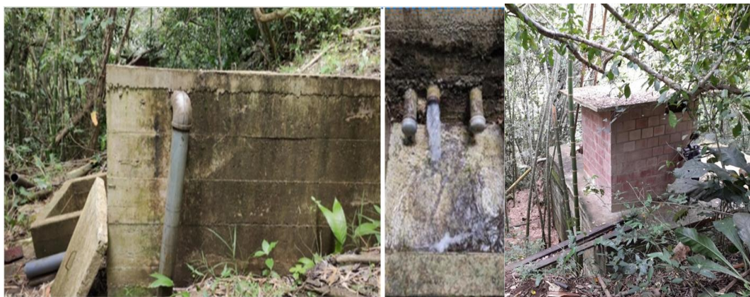
Figura 43. Tanque desarenador Tanque de almacenamiento ASOCAT.
