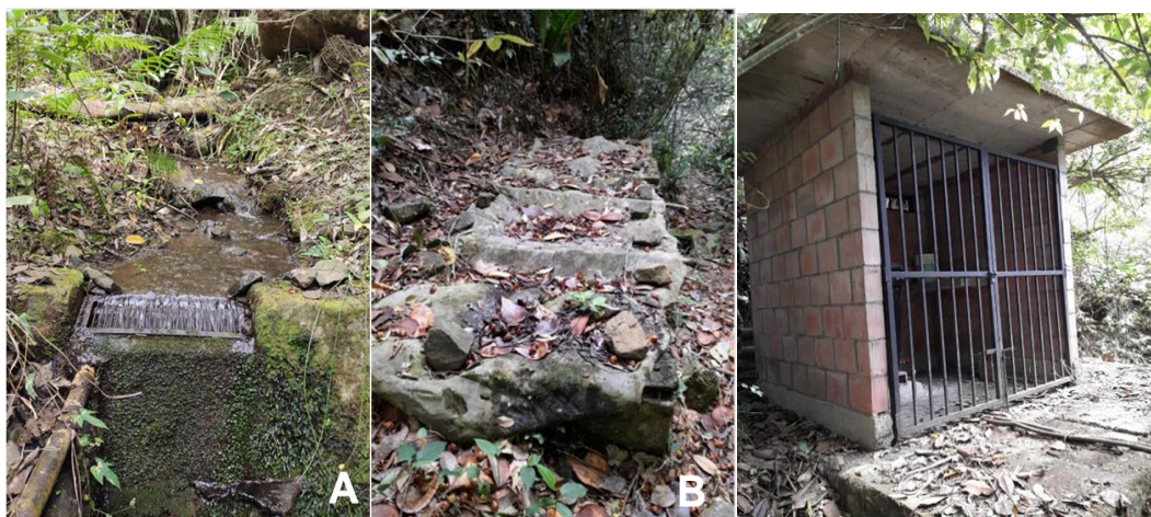
Figura 44. A: Captación del agua, B: Tanque desarenador; Tanque de almacenamiento ASOVIGÍA.
