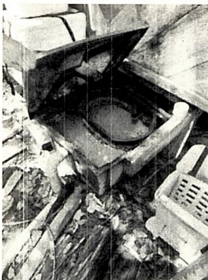
Foto N° 3. Trampa de grasas a la salida área de cocina
