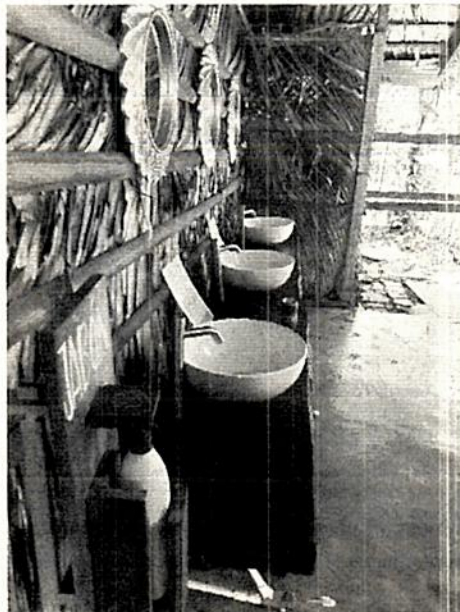
Foto N° 5. Lavamanos de zona común
