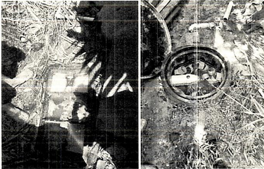
Foto N° 4. Entrada y estructura del sistema séptico integrado
