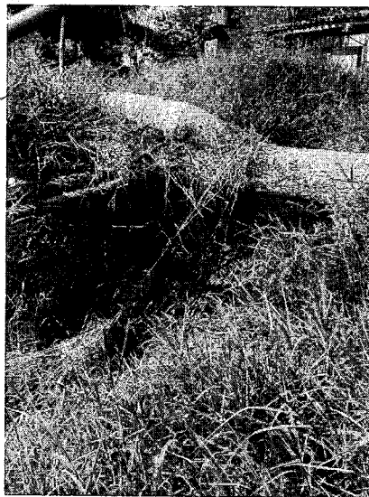
Figura 4. Canal de conducción del vertimiento sólido y líquido
