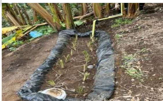
Foto 96. Sistema descontaminación de aguas residuales con pasto vetiver, Argelia. Archivo CVC, 2024.
