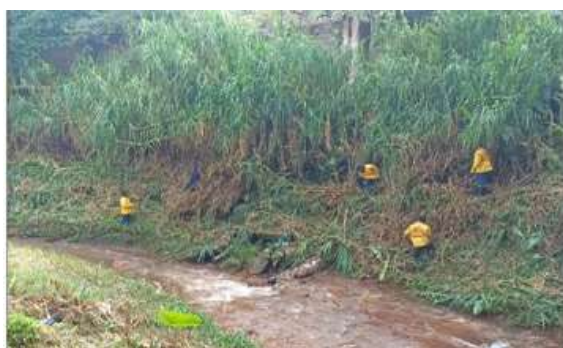
Foto 130. Retiro manual de residuos sólidos a orilla de cauce. Archivo CVC, 2024
