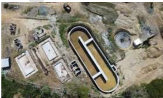
Foto 84. Construcción de la PTAR de la cabecera municipal de El Dovio. Archivo CVC, 2024
