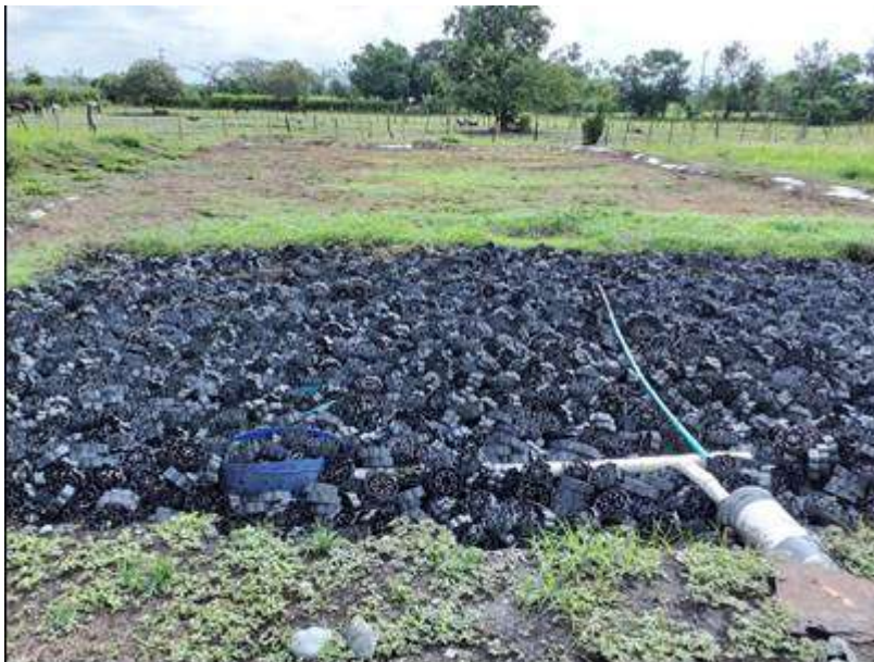
Foto 7. Filtro anaeróbico o laguna sub superficial de flujo ascendente. En la parte inferior de la foto se observa los rosetones o galletas.
