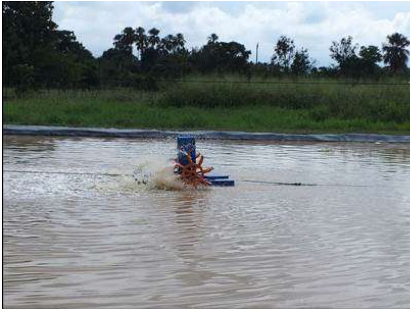
Foto 6. Elemento aireador de la laguna facultativa. Incorporación de oxígeno.
