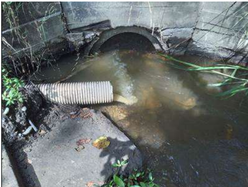
Foto 9. Descarga final de las aguas residuales a un canal de drenaje de aguas lluvias. Tubería PVC corrugada de 10 pulgadas.
