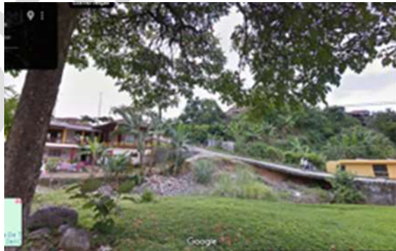
Foto 107. Socavación bajo la calzada hasta el inicio del puente. Fuente: Google Street view. 2024
