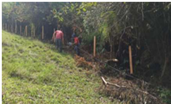
Foto 34. Aislamiento de protección predio Potrerito, cuenca Tuluá - municipio de Tuluá - Vereda Mateguadua. Archivo CVC, 2024
