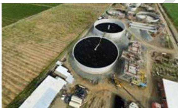
Foto 98. Etapa final del proceso de construcción y entrada en operación de la PTAR del municipio de Buga. Archivo CVC, 2024
