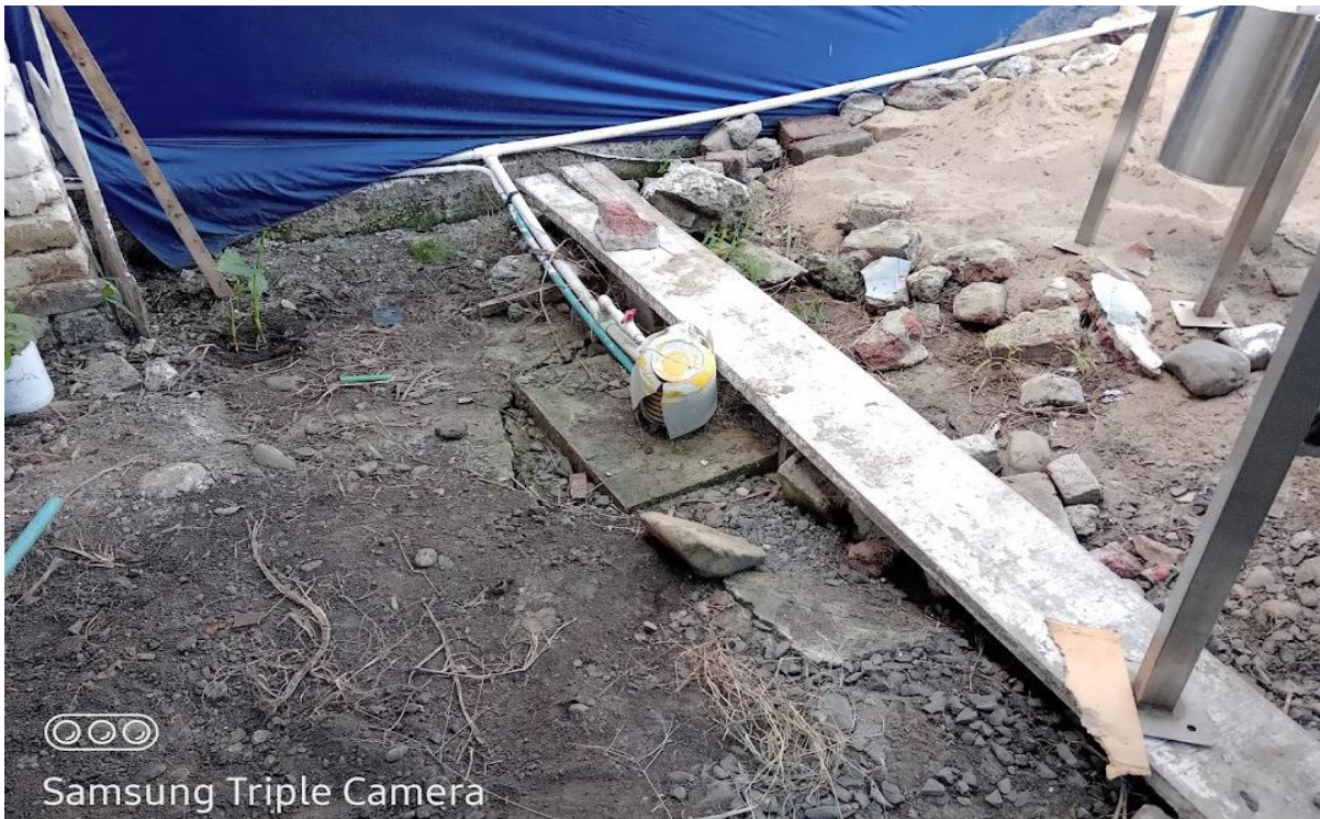
Foto No. 2. Ubicación del aljibe a ras de suelo, con instalación eléctrica y tubería de conducción.
