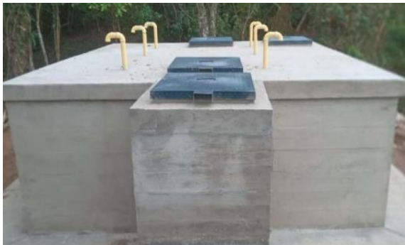
Foto 87. Tanque de almacenamiento del sistema de abastecimiento para la comunidad indígena Nasa Tha en el Municipio de Florida. Archivo CVC, 2025.
