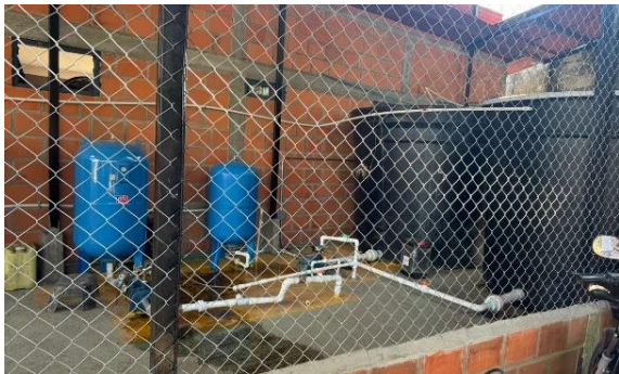
Foto 89. Seguimiento permisos de vertimiento. Sistema de tratamiento de agua para uso y aprovechamiento. DAR Norte, predio Los Almendros, Vereda La Estrella, Municipio de Alcalá. Archivo CVC, 2025
