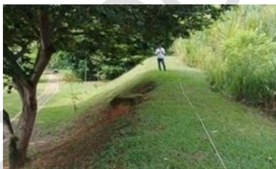
Foto 111. Margen derecha del río Meléndez, sitios a diseñar con erosión de orilla. Archivo CVC, 2025
