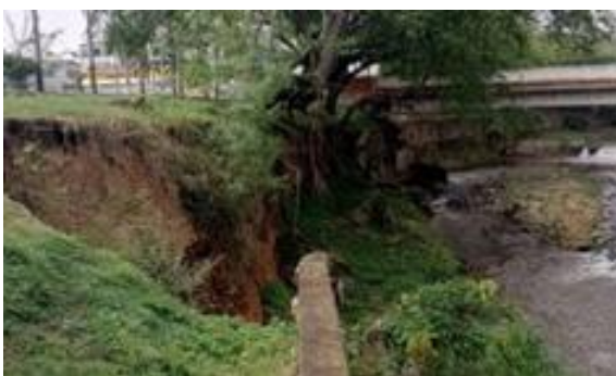
Foto 110. Margen derecha del río Cali, sitios a diseñar con erosión de orilla. Archivo CVC, 2025.
