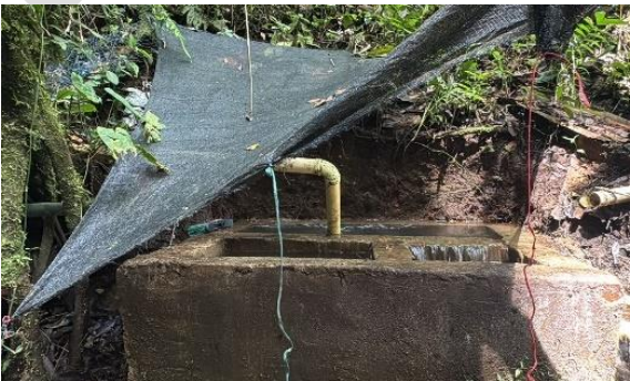
Foto 93. Tanque desarenador, concesión de aguas en el municipio de Ulloa. Archivo CVC, 2025.
