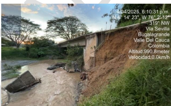
Foto 99. Daño en el talud del trasdós del estribo derecho del puente sobre el río La Paila vía Bugalagrande-Sevilla. Archivo CVC, 2025
