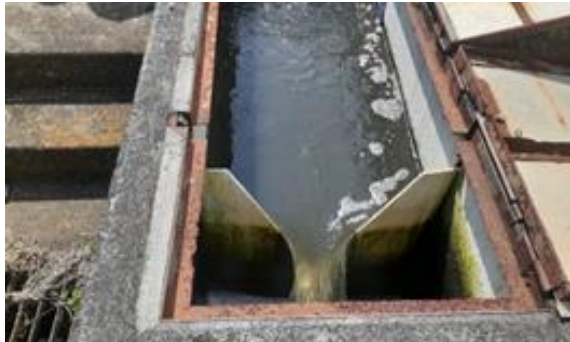
Foto 135. Seguimiento PTAR Cabecera Urbana Calima El Darién, estructura de medición del caudal efluente final que vierte en el embalse Calima. Archivo CVC, 2025.
