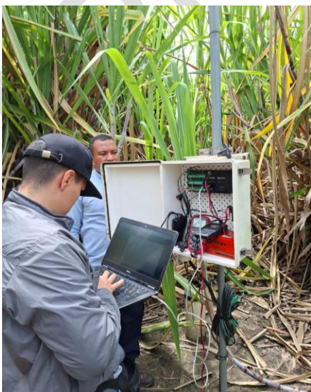
Foto 5. Mantenimiento de estaciones de monitoreo de suelos automatizadas (Detalle 1). Archivo CVC, 2025.
