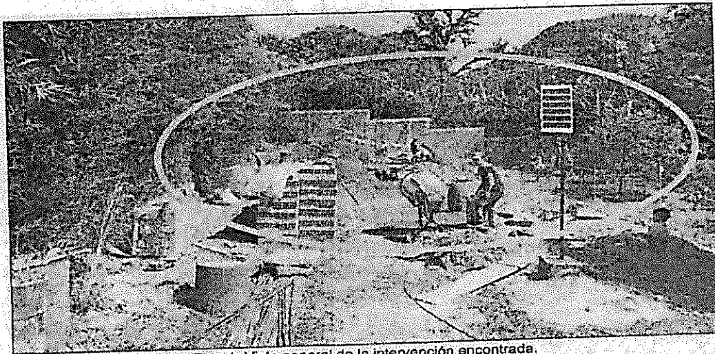
Foto 1. Vista general de la intervención encontrada.
