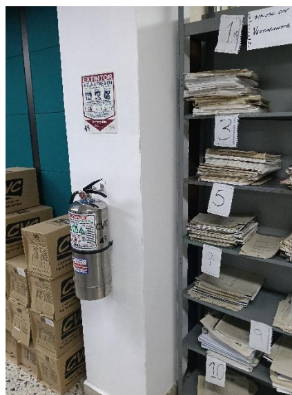
Fotografía 19. Extintores Archivo Central DAR Suroccidente
