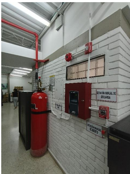
Fotografía 18. Red contra incendios Archivo Histórico
