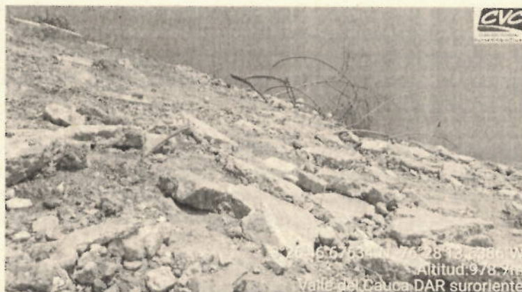
Imagen 6. Evidencia de utilización de RCD (Bloques de concreto) 5 de diciembre
