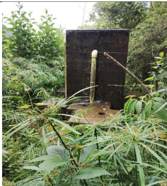
Tanque Desarenador Captación Q. La Soledad (Coordenadas geográficas: 3.493162N; -76.561695W)
