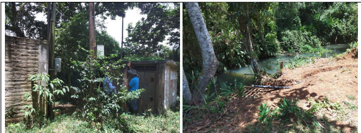
Infraestructura para captación por bombeo del río Pavas, con aprovechamientos puntuales en régimen de operación sin control, mientras que la asignación se otorga para un régimen de operación de 24 horas.
