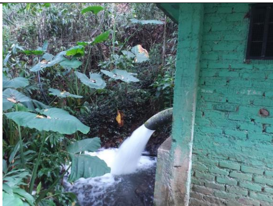
Acueducto de Párraga – Caseta de bombeo, con agua del río Pavas
