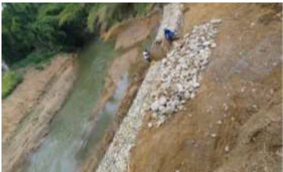
Foto 140. Seguimiento expediente 0711-036-015-078-2025, al trámite permiso de ocupación de cauce de la sociedad El Caimito S.A.S., tendiente a corregir dos derrumbes identificados en los sectores K3+640 y K3+660 de la margen derecha del Río Jamundí, en las inmediaciones del predio denominado "Lote La Unión CCVA". Archivo CVC 2026.
