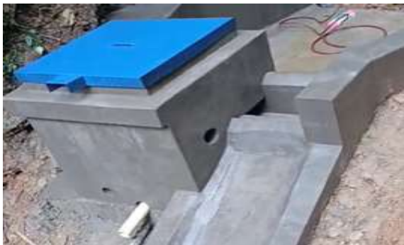
Foto 135. Acueducto Resguardo Dachi Drua Mundi, Ansermanuevo. Archivo CVC 2026.
