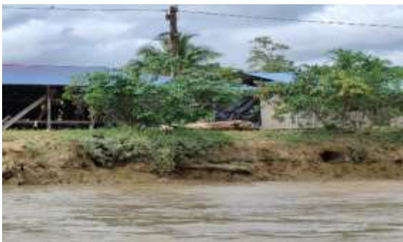
Foto 175. Amenaza por procesos de remoción en masa en terraza aluvial y socavación en el río San Juan. Archivo CVC 2026
