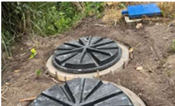
Foto 131. Tanques Sépticos resguardo Umada Mia del municipio de El Dovio. Archivo CVC 2026.
