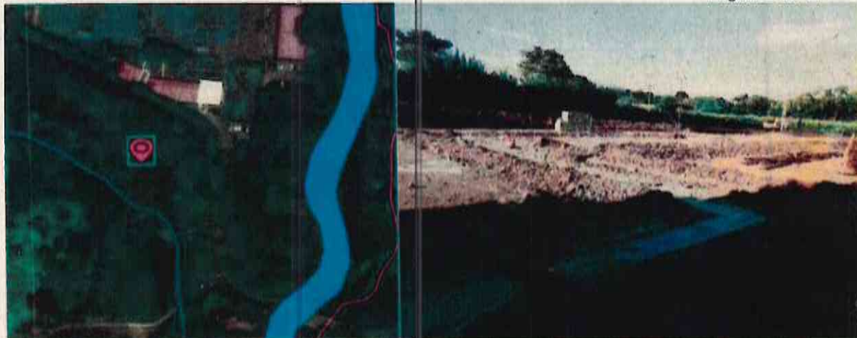
Imágenes 1 y 2. Localización del área donde se evidenció la presunta infracción, por la apertura de una explanación, para, según se indicó, construir unas cachas deportivas. Fuente GeoCVC/Google Earth, IDESC
