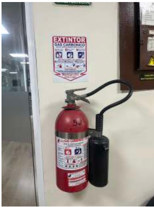
Foto 18. Extintor tipo B y C
