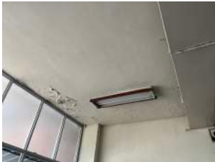
Foto 7. Humedad cielo raso – Almacén
