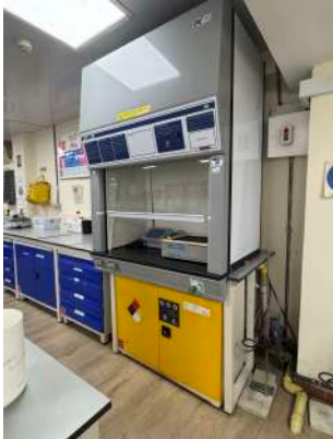
Fotografía 6 – Cabina extractora de gases y humos
