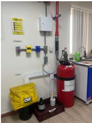
Foto 20. Tanque gas contra incendio
